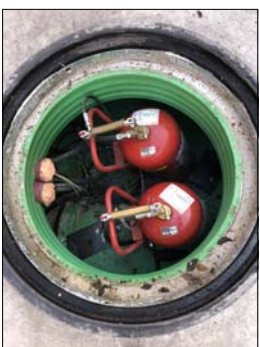
ARQUETA CON AGENTE EXTINTOR
