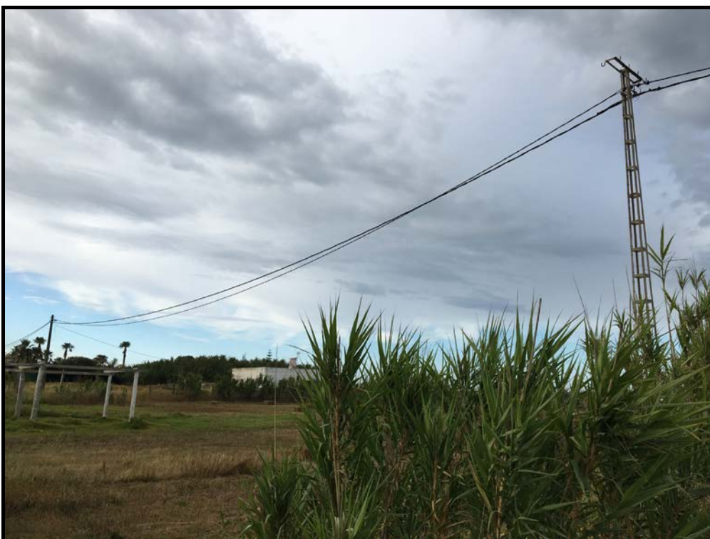
Foto 30: Vista de postes de luz de media tensión atravesando la parcela de Noroeste a Sureste.
