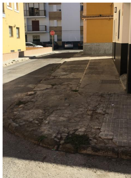
Acerado en mal estado
