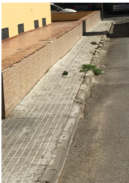
Acerado muy estrecho y en mal estado
